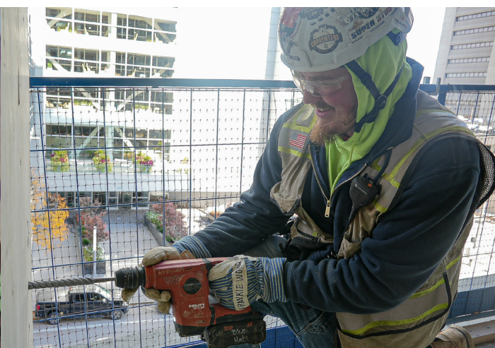
Frank Dolincheck V (Local 427 - Omaha, NE) perfora con martillo los agujeros de la barrera del cable en las columnas de la rampa de estacionamiento.
